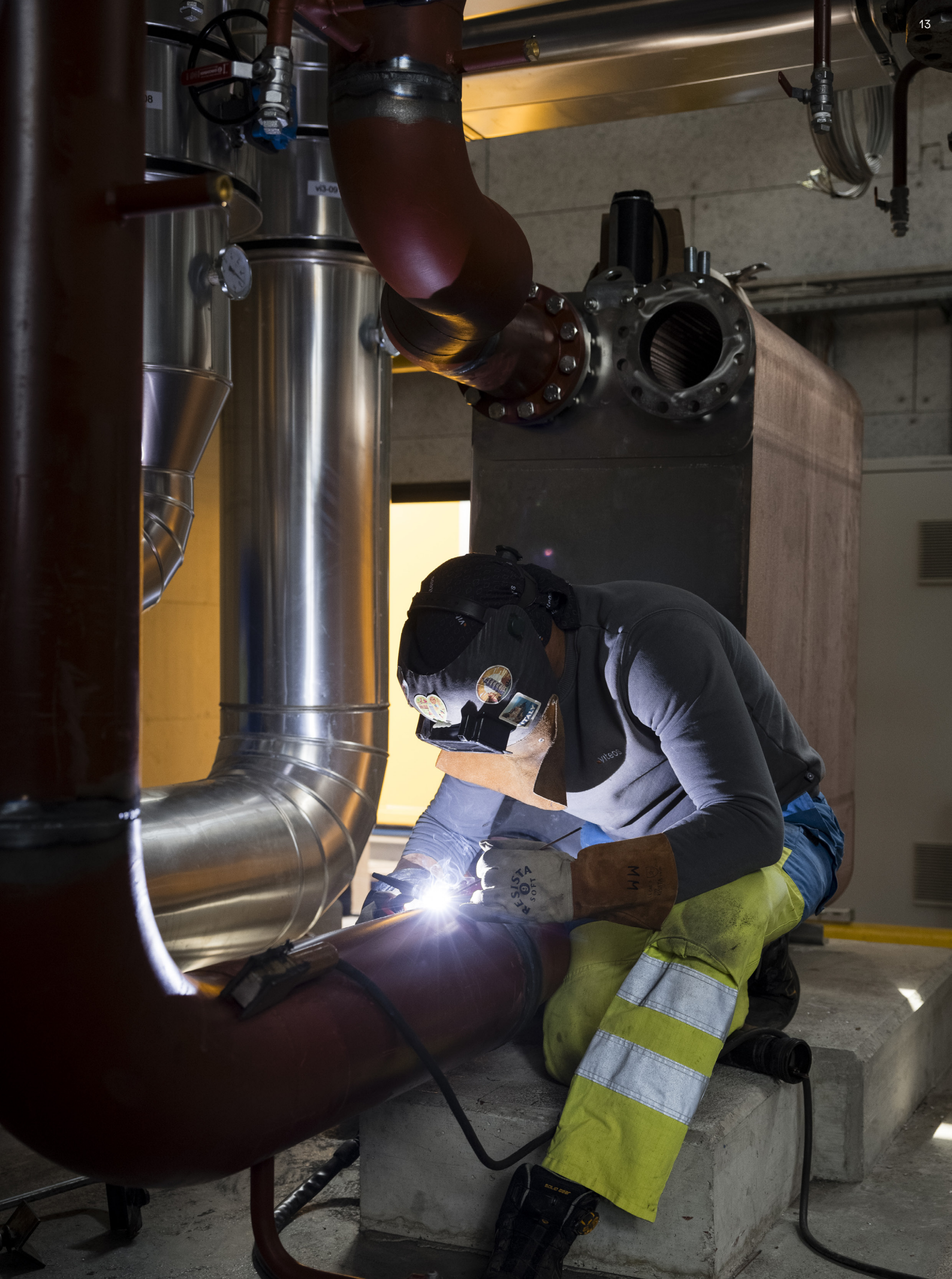
Dans les coulisses du CAD, des équipes engagées relèvent chaque jour des défis techniques pour garantir l'approvisionnement en chaleur.
