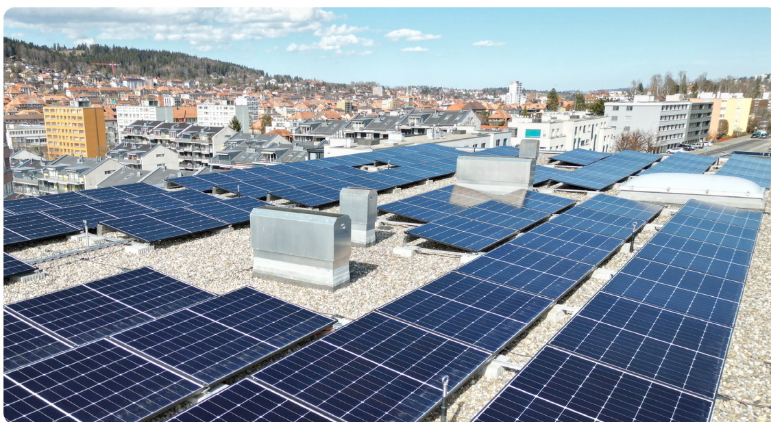
Installation photovoltaïque à La Chaux-de-Fonds
